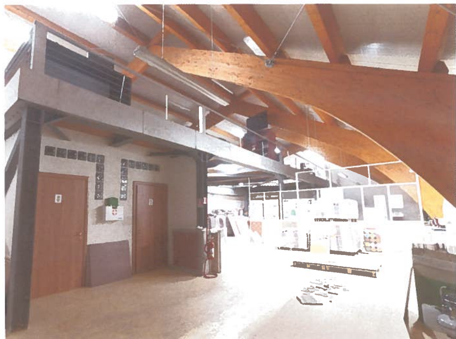
IL SOPPALCO IN METALLO è una struttura radiante che utilizza per il riscaldamento un fluido vettore a bassa temperatura.
